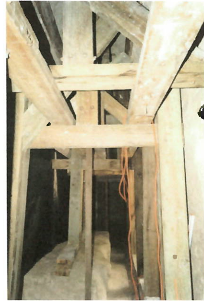
Apuntalamiento de bóveda en donde se registró el colapso de una parte y tiene problemas de estabilidad estructural.
